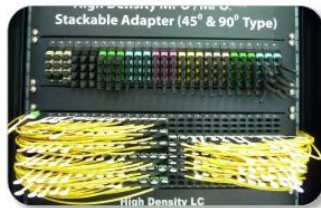
Data center display
